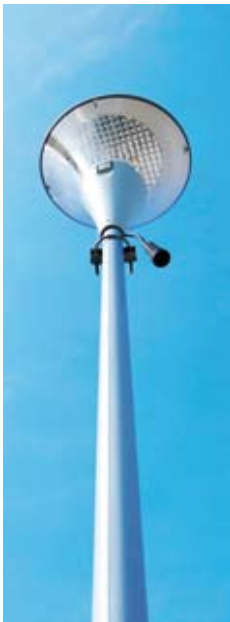
Gesamte Straßenbeleuchtung wurde auf umweltschonende und energiesparende LED-Leuchten umgestellt
