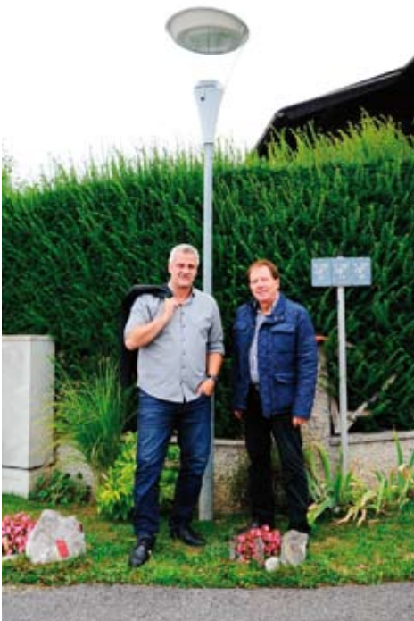
Energiesparende LED-Strassenbeleuchtung wurde 2016 weiter ausgebaut. Im Jahr 2017 wird die Umstellung auf LED-Beleuchtung abgeschlossen. Dann ist die gesamte Strassenbeleuchtung in Wiesen und im Ortsteil bei Bad Sauerbrunn und am Keltenberg umgestellt.
